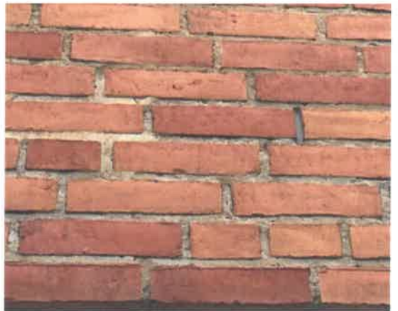
Slidte fuger som falder ud
