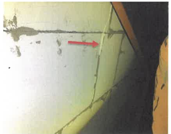
Forskydningsrevne i brandmur
